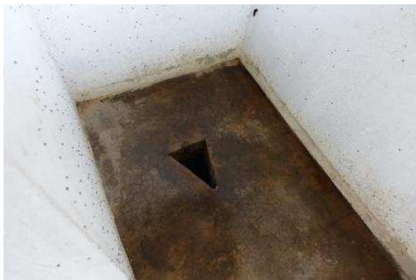
Die alten Toiletten in einem dunklen Raum ohne Wasser
